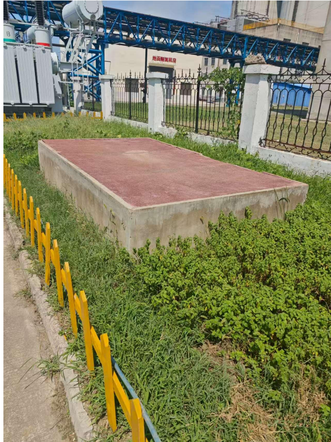
图 5.7-1 现有事故油池
